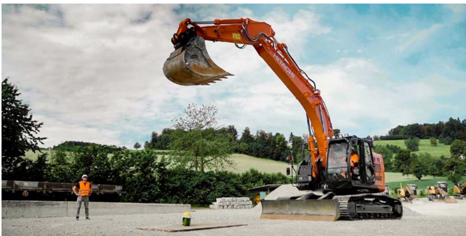
Arbeiten im Fahr- und Schwenkbereich der Baumaschinen sind gefährlich, auch wenn moderne Geräte über Sensoren, Bewegungsmelder und andere Sicherheitsvorrichtungen verfügen.
