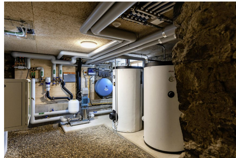
Die moderne Wärmepumpe erobert auch alte Gebäude: Blick in den Keller eines 300-jährigen Bauernhauses in Ruswil LU. Um die Speicher unterzubringen, musste der Boden tiefergelegt werden.
