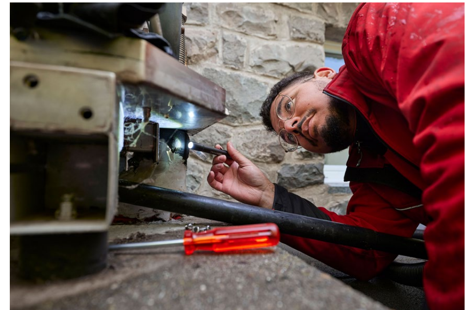
Genaueres Hinschauen ist gefragt: Ein Servicetechniker kontrolliert den Kondenswasserablauf einer Luft-Wasser-Wärmepumpe.
