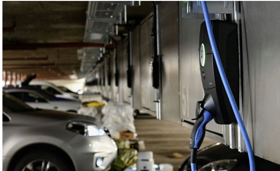
Die erste Ladestation in der Einstellhalle ist bereits montiert, 49 weitere können im Handumdrehen nachgerüstet werden.
