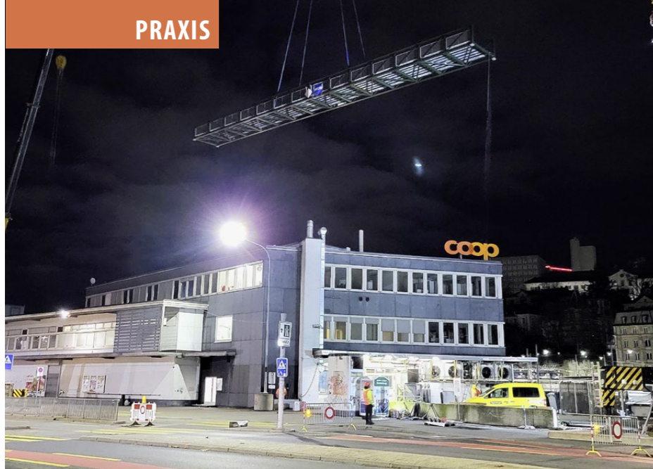
Das Brückenteil wird behutsam hochgehoben. Es darf keine Eigenschwingung erhalten, sonst könnte es ausser Kontrolle geraten.
