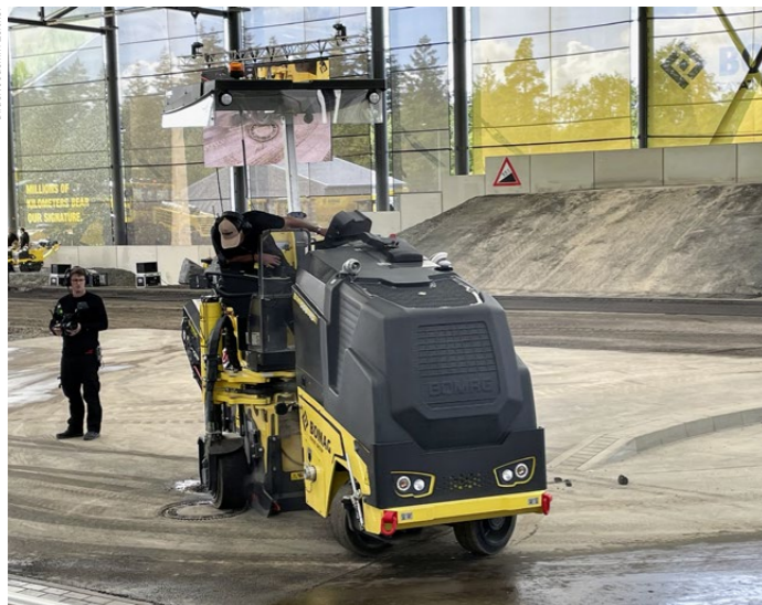
Beim filigranen Arbeiten rund um einen Schachtdeckel erweist sich die Kleinfräse Bomag BM 500 als wendiger Allrounder im innerstädtischen Asphalt-Patchwork.
