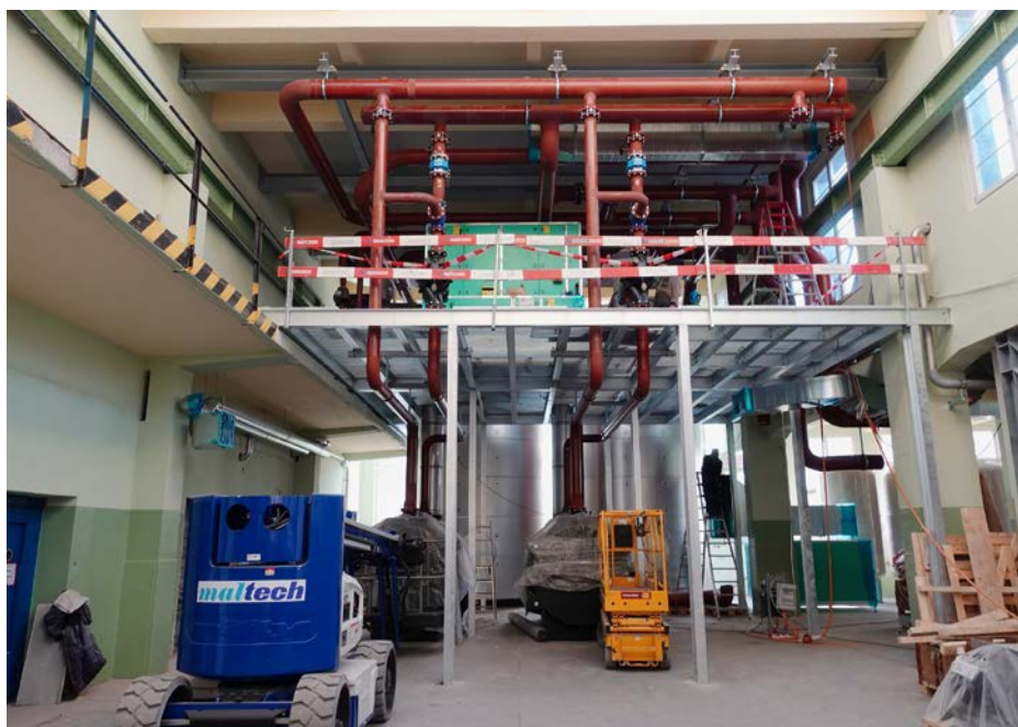
In der Energiezentrale stehen zwei Maschinenräume für vier Wärmepumpen mit einer Abgabeleistung von je 1400 Kilowatt bereit. Die Kapazität ist abgestimmt auf die konzessionierte Wassermenge.
