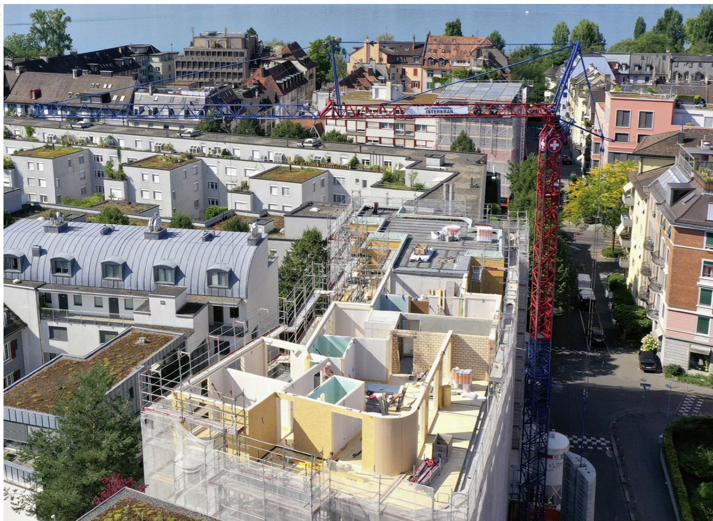
Am Zürcher Seefeld entstanden mit einer Aufstockung gleich vier neue Wohnungen auf einem Mehrfamilienhaus aus den 1930er Jahren.
