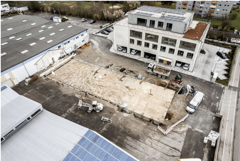
Die noch leere Baustelle des Mineralschaumbaus, im Hintergrund die neue Zuber Beton-Verwaltung.
