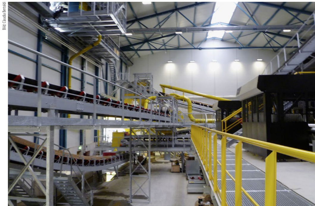
In der modernen Aufbereitungsanlage kann rund um die Uhr Recyclingmaterial aus dem Abbruch mit konstanter Leistung und verlässlicher Qualität sortiert werden.
