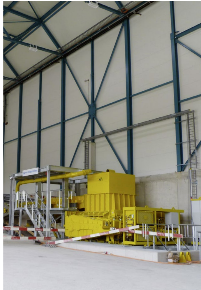
Der Sizer ist eine Maschine, die das von einem Sortierbagger vorsortierte Material grob zerkleinert. Danach separieren sechs Roboter die Wertstoffe.
