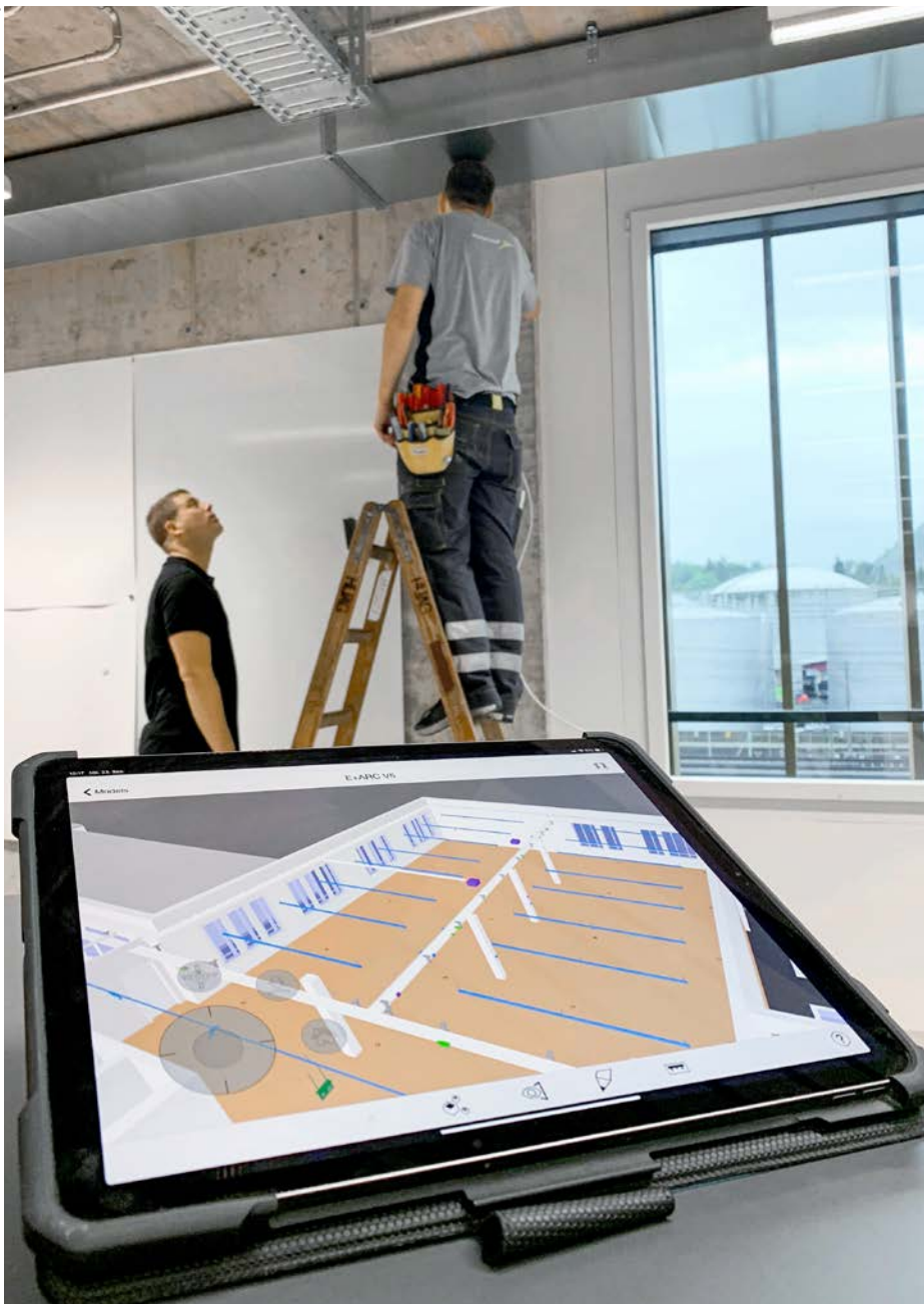
Von der Blackbox zum transparenten Gewerk: Mit Hilfe des BIM-Modells können auch spätere Anpassungen an der Elektroinstallation problemlos ausgeführt werden.
