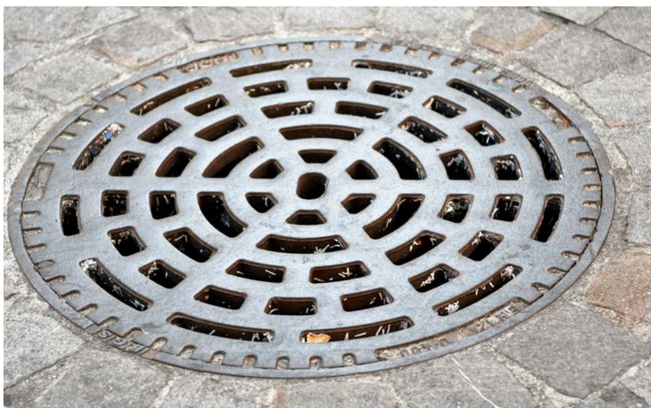
Dieser Einlaufdeckel aus den 1950er-Jahren dient der Entsorgung von Meteorwasser.
