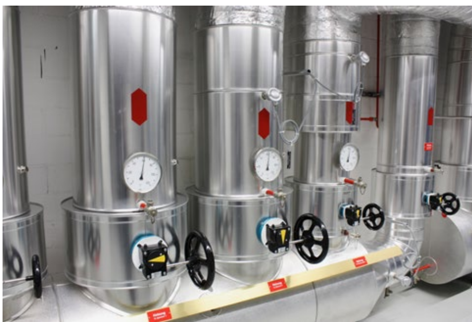
Kessel und Röhre, Regler und Anzeigen – der Betrieb in der See-Energiezentrale Inseliquai in Luzern wird seit dem Umbau rund um die Uhr von der EWL-Zentrale aus gesteuert und überwacht.
