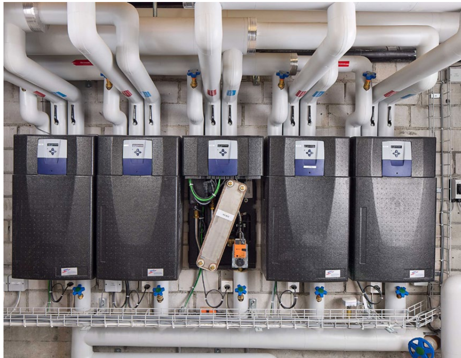
Das Warmwasser für die gesamte Anlage (inklusive Tschuggen Bergoase) wird mit leistungsfähigen Frischwasserstationen aufbereitet.
