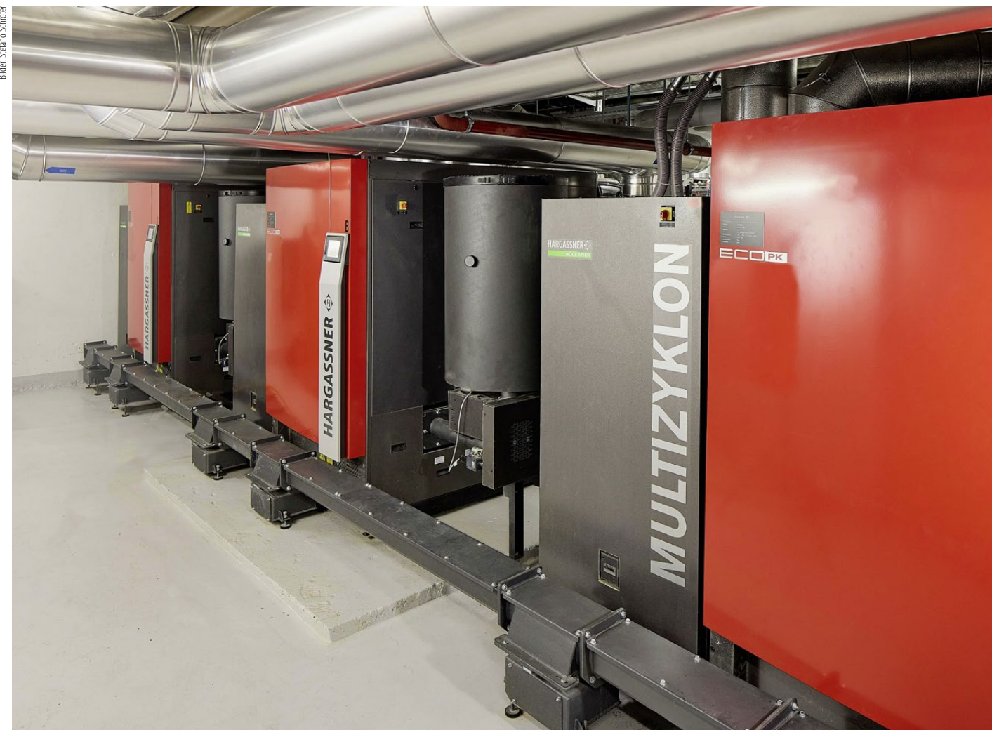
Drei Pelletheizkessel mit einer Leistung von jeweils 330 Kilowatt liefern die nötige Energie für Raumwärme und Warmwasser.
