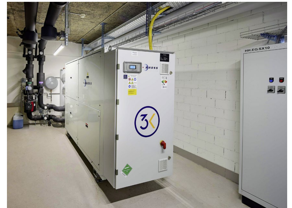
Blick auf die Inneneinheit der neuen Wärmepumpe.
