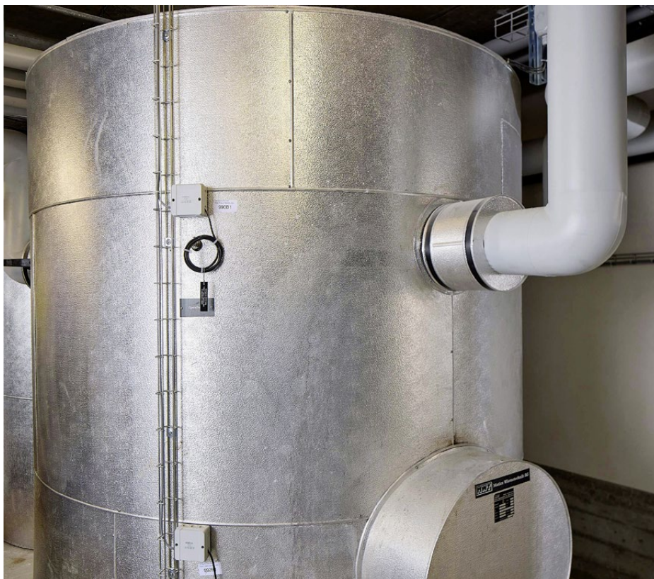
Die früheren Warmwasserspeicher dienen neu als Heizungsspeicher – ein weiterer Beitrag zur Nachhaltigkeit.
