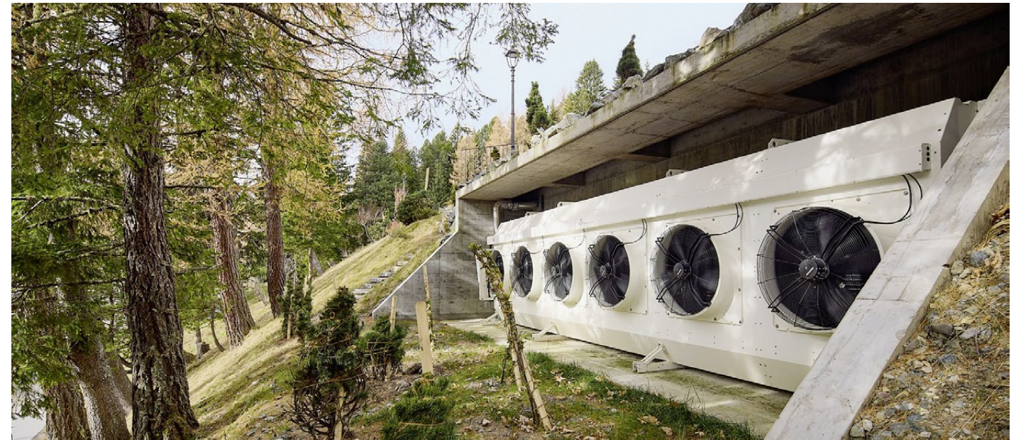
Der Rückkühler der neuen Grosswärmepumpe wurde unauffällig in den Hang unter dem Haupthaus integriert.
