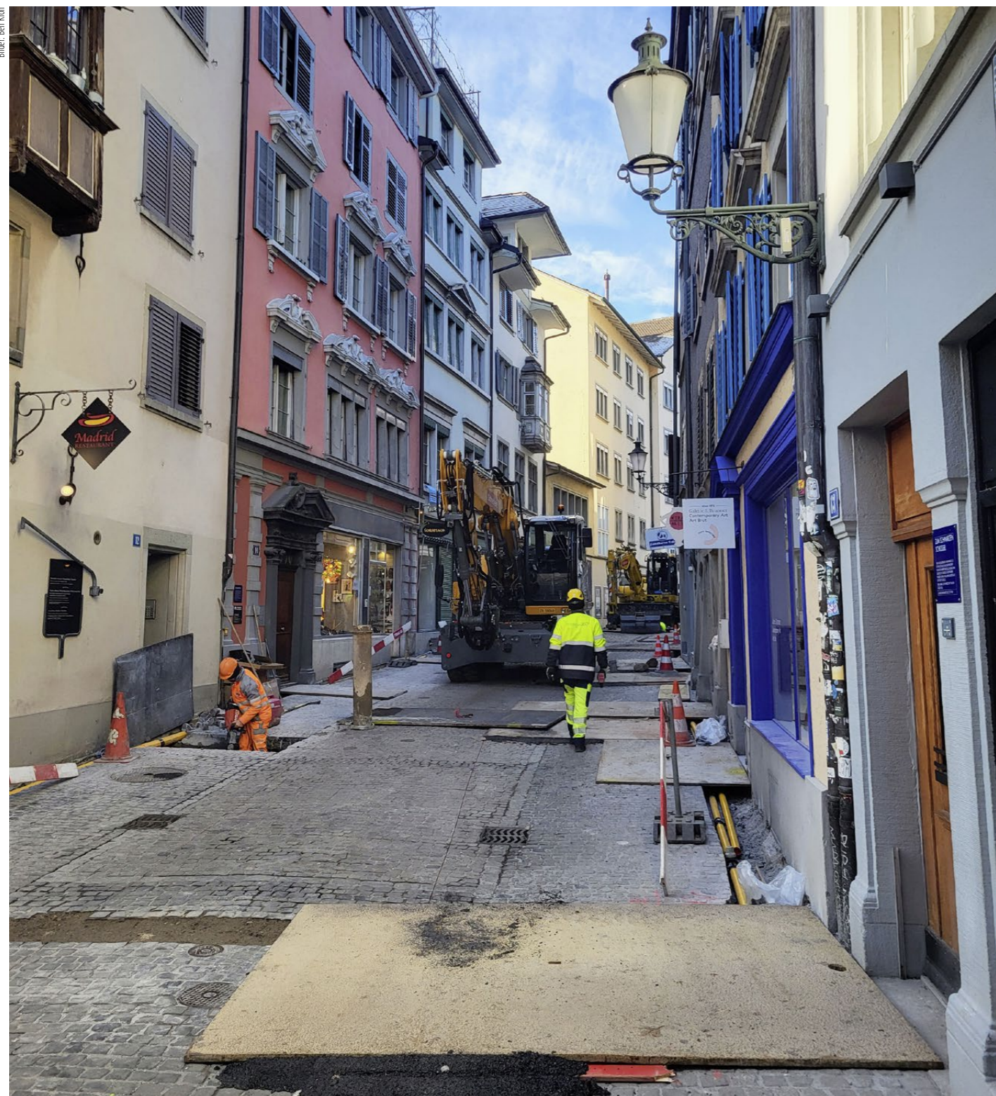
Bauarbeiten ohne Absperungen: Dank ausgeklügeltem Sicherheitskonzept und erfahreinem Personal auf der Baustelle möglich.
