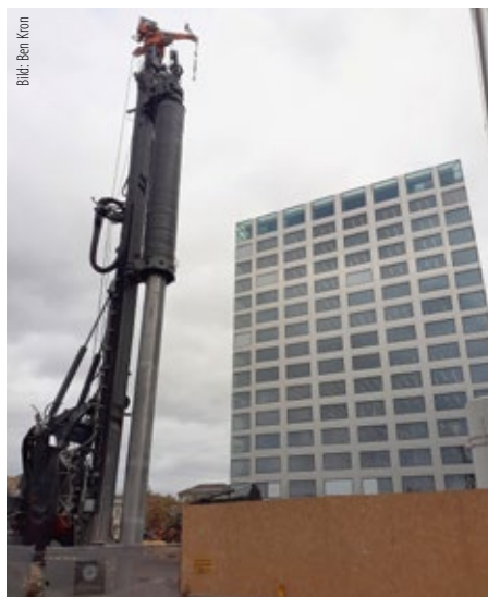
Mahnendes Beispiel: Der Neubau des Biozentrums dauerte drei Jahre länger als geplant und kostete über 100 Millionen Franken mehr.
