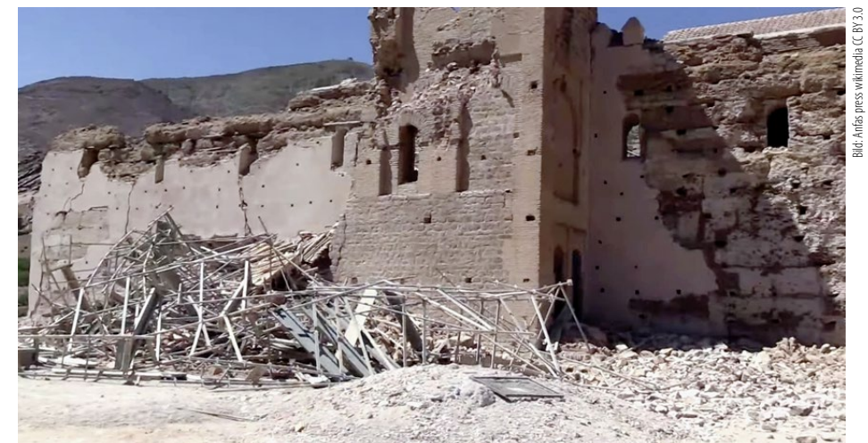
Beim Erdbeben wurde die Moschee massiv beschädigt. Das Minarett, die Arkaden des Gebetsaals sowie ein Grossteil der Stampflehm-mauern sind eingestürzt.
