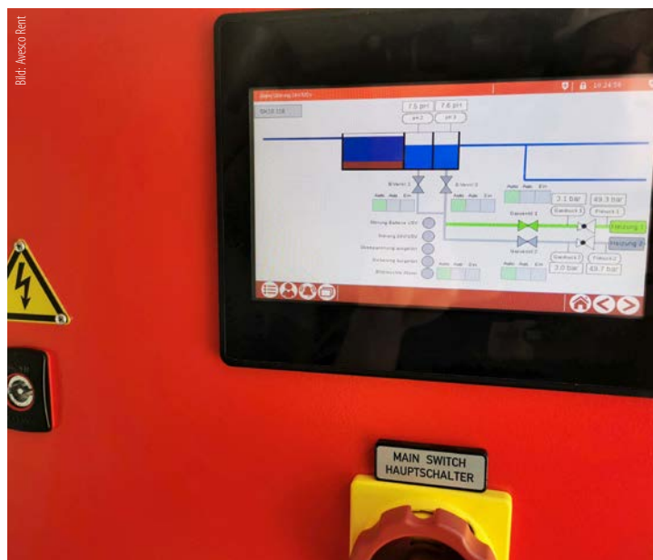
In der Steuerkabine wird neben dem pH-Wert und der Spannung auch der Gasdruck kontrolliert.
