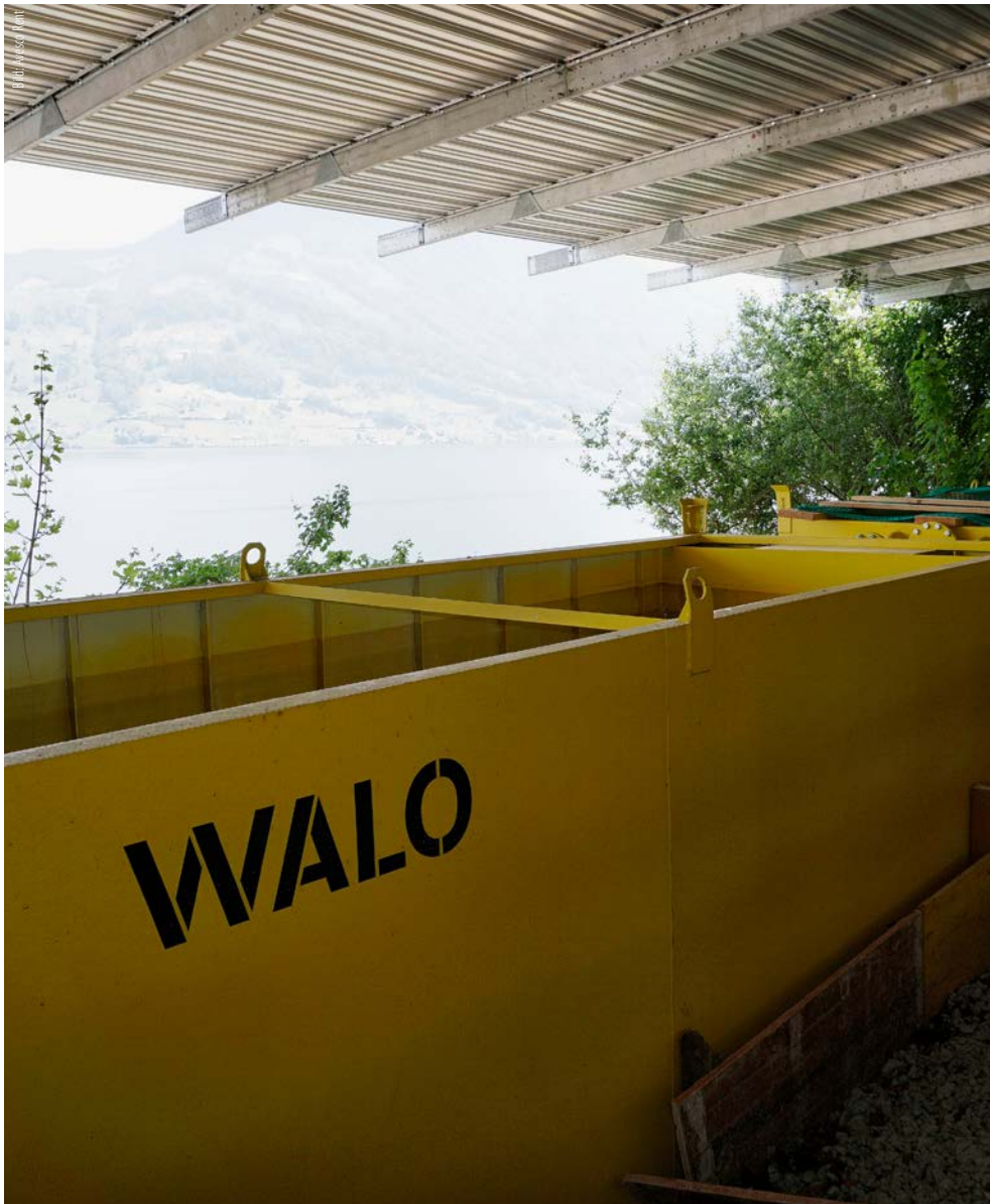
In zwei 40 Kubikmeter grossen Becken wird das Wasser für die HDW-Arbeiten gespeichert.
