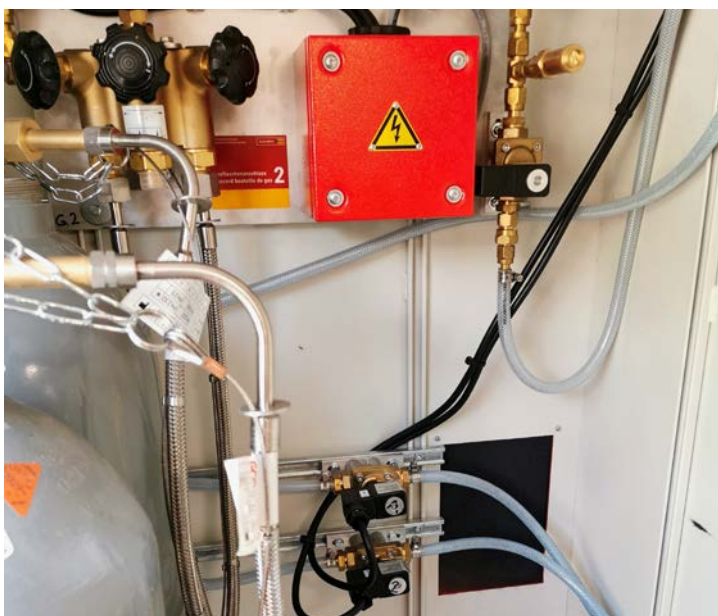
Sichere CO 2 -Versorgung: Wenn eine Gasflasche leer ist, schaltet das System automatisch auf die andere Gasversorgungsseite um.
