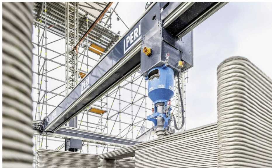
Bau des Mehrfamilienhauses in Weissenhorn: Betonwurst für Betonwurst zieht der 3D-Drucker eine Wand in die Höhe, und schafft eine Geschwindigkeit von einem Meter pro Sekunde.
