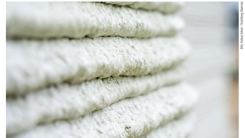
Charakteristisch: Die 3D-gedruckte Mauer sieht aus, als hätte sie einen Kammzugputz erhalten.
