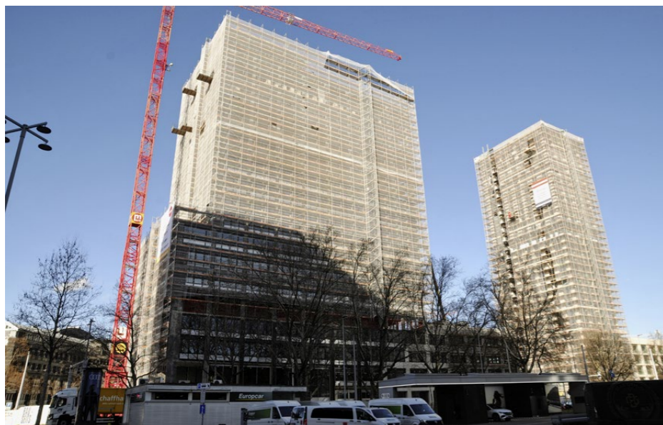
Der Hochhaus-Boom in Oerlikon geht weiter: Die Rohbauten des Messeturms und des Artisa-Towers sind fertig.
