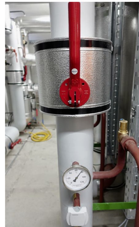
Die Energiezentrale, von welcher 41 Wohnungen mit Wärme versorgt werden, ist pragmatisch in einem kleinen Raum von drei auf vier Metern eingerichtet.
