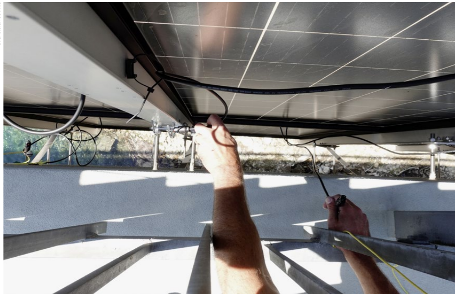
Die PV-Fläche besteht aus Doppelglaspanelen, die von heftigen Winden verursachten Belastungen besser standhalten.
