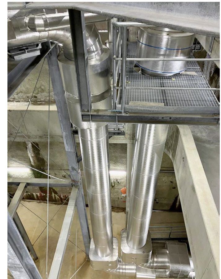
In diesen Rohren, die sich in einem 20 Meter tiefen Schacht an der Milchbuckstrasse befinden, wird das Wasser auf 105 Grad erhitzt.
