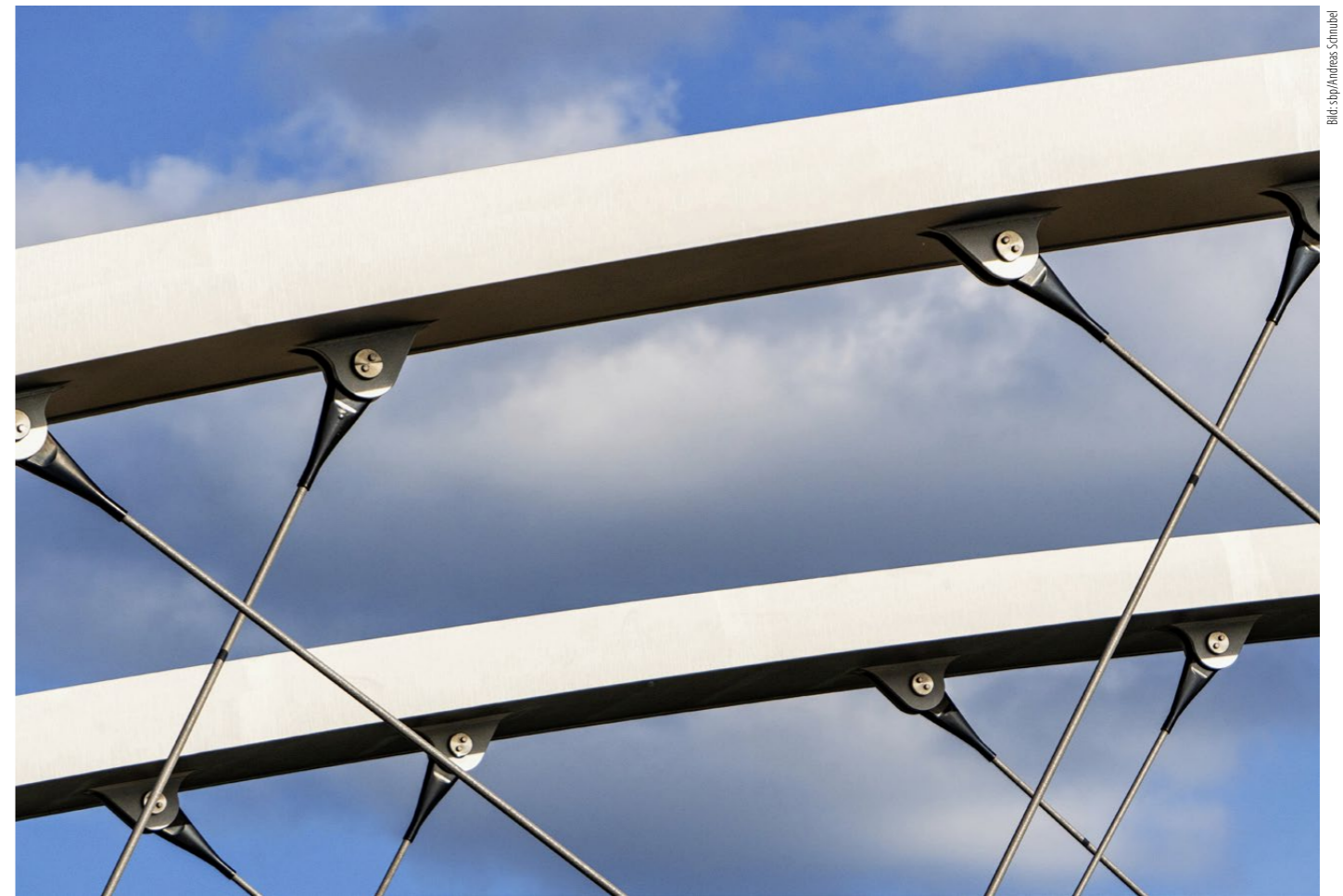
Neuer Werkstoff für eine klassische Konstruktion: Die Seile aus kohlefaserverstärktem Kunststoff und ihre Befestigung an den beiden Brückenbögen.
