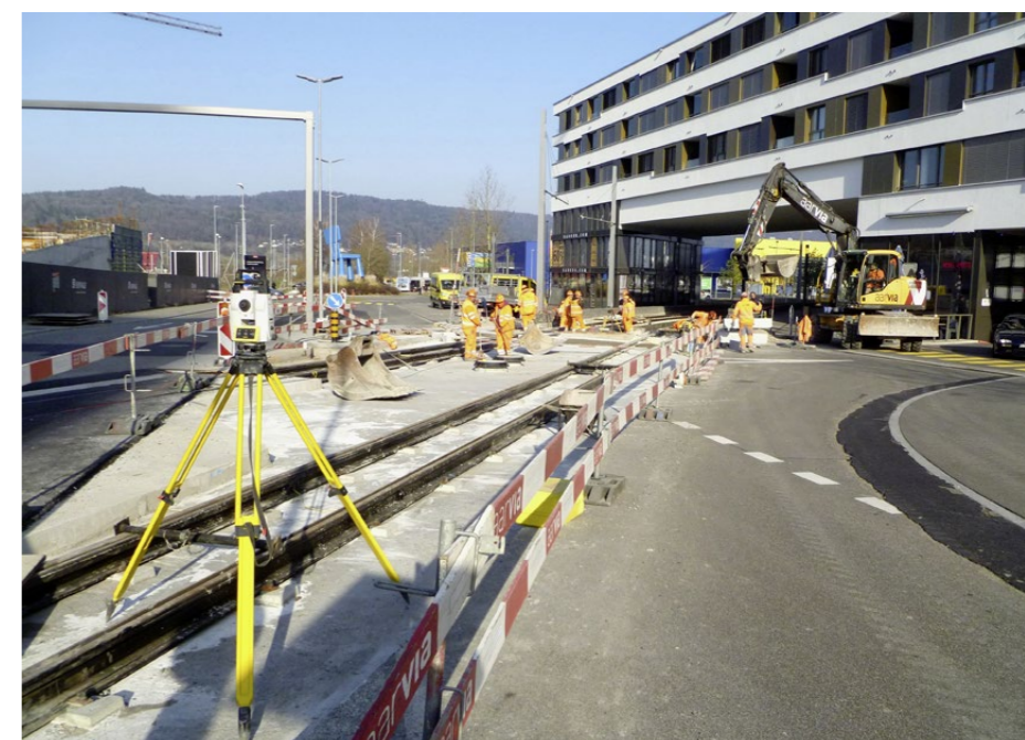
Bauarbeiten an der Limmattalbahn bei Spreitenbach. Die Bahn wird bald nach Killwangen fahren, doch die angedachte Verlängerung bis nach Baden stösst zunehmend auf Kritik und Widerstand.
