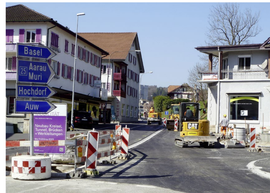
Endspurt bei den Bauarbeiten für die Südwestumfahrung Sins, die auf rund 88 Millionen Franken zu stehen kommt. Die Eröffnung erfolgt im September, letzte kleinere Arbeiten ziehen sich noch etwas länger hin.
