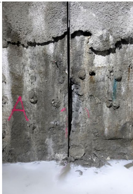
Die ursprüngliche Ausbruchsicherung wird im rückwärtigen Bereich in Etappen geschnitten, rückgebaut und dann durch eine verstärkte Ausbruchsicherung ersetzt. Hangbewegungen brachten den Spritzbeton zum Abplatzen (Bild).
