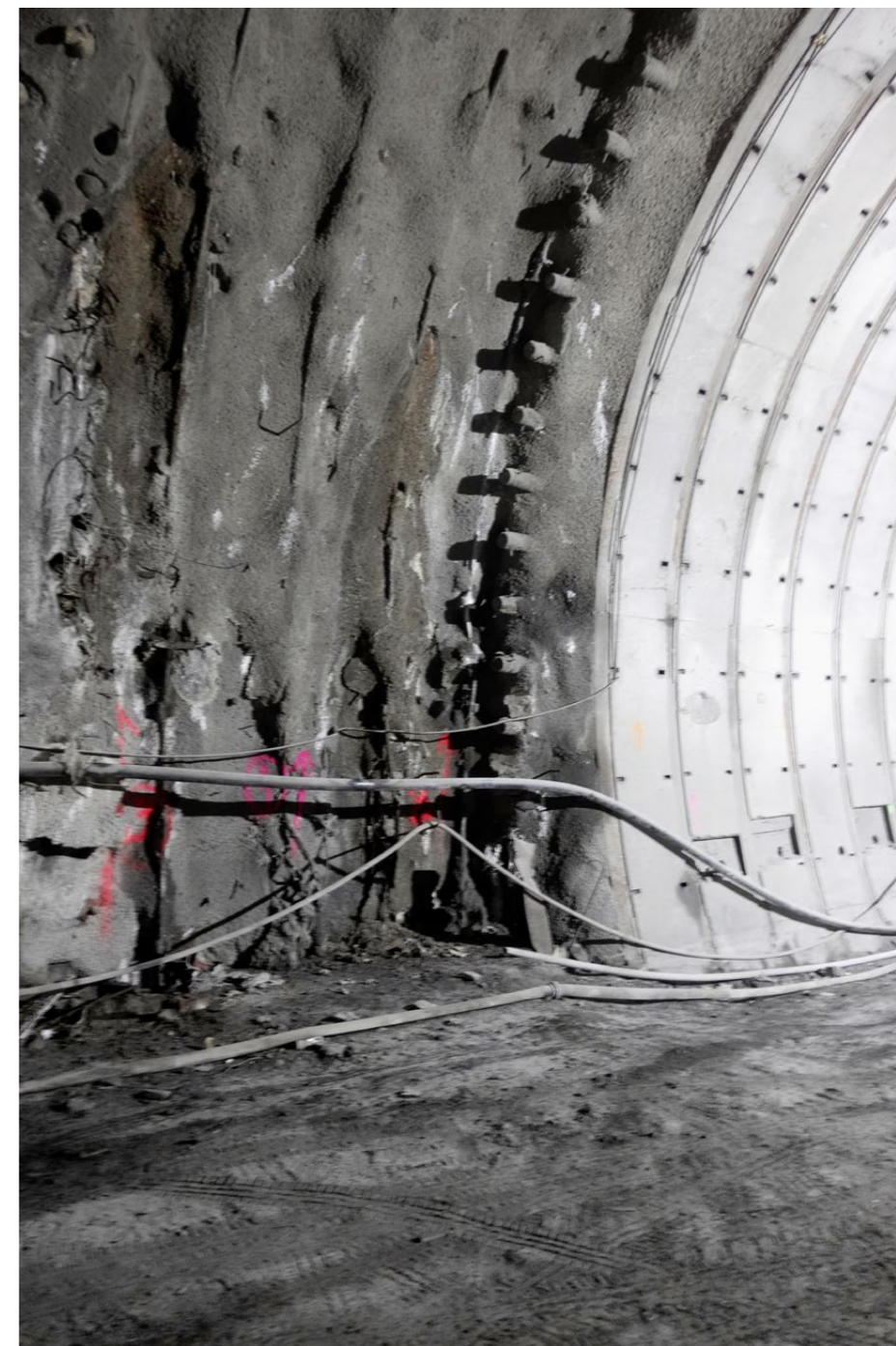
Die verstärkte Ausbruchsicherung ermöglicht die Aufnahme der Lasten aus dem Baugrund. Die alte Sicherung besteht aus Gitterträgern und zwei Spritzbetonschichten mit einem Stahlnetz dazwischen.
