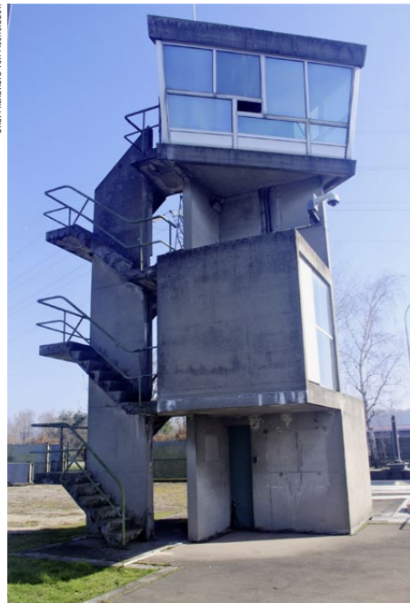
Seit 1995 steht der Turm des Schleusenwärters leer. Die Treppe zeigt massive Schäden durch Witterungseinflüsse.
