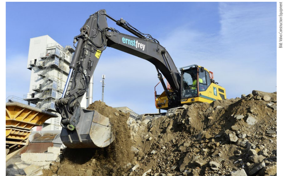
Im Recyclingzentrum der Ernst Frey AG, Kaiseraugst, arbeitet ein Volvo-Bagger EC300E Hybrid. Die Energie von Abwärtsbewegungen des Auslegers dient zur Unterstützung der Hydraulik.
